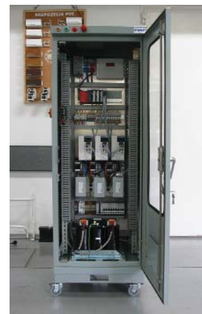
Rys. 2. Szafa sterownicza zautomatyzowanego stanowiska badawczego
